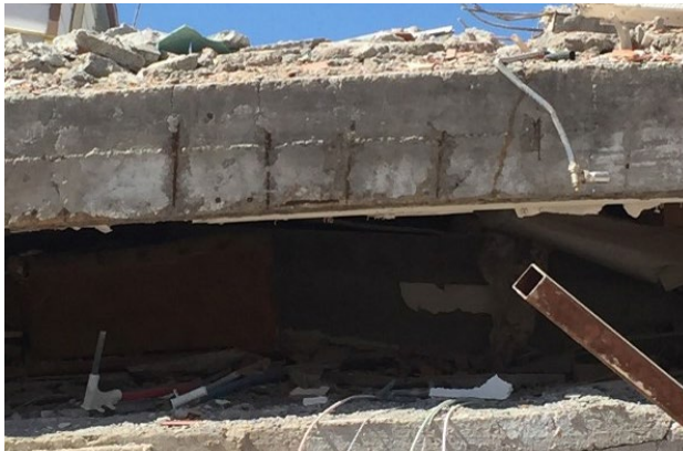
Şekil 14: Göçüntüdeki Yapı Taşıyıcı Elemanlarında Sargılama Problemleri Yeni Sanayi Mah. Merkez/ Adıyaman 37,75317 K; 38,24611
