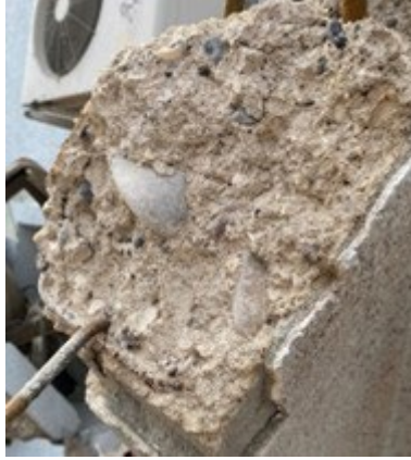
Şekil 10: Düşük Kaliteli Beton ve Uygun Olmayan Agrega Kullanımının Görüldüğü Taşıyıcı Eleman Örneği
