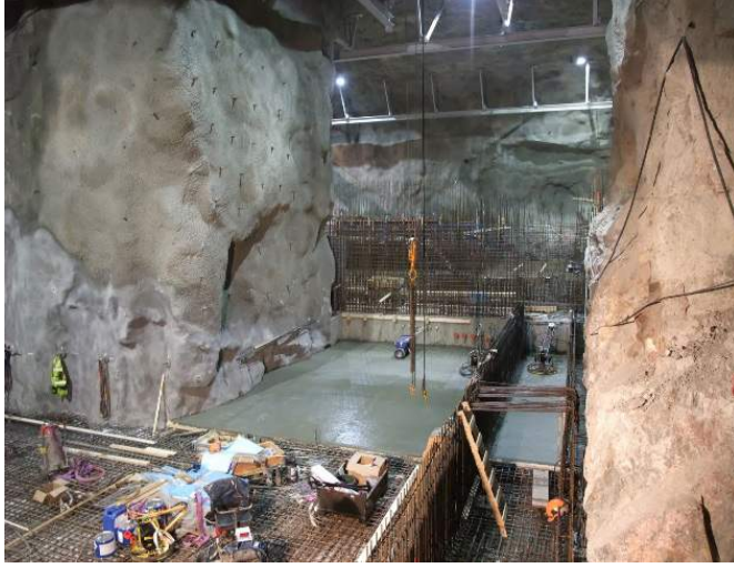
Fotoğraf 71: Stockholm'de Tamamen Yer Altında İnşâ Edilen Atık Su Arıtma Tesisi 295
